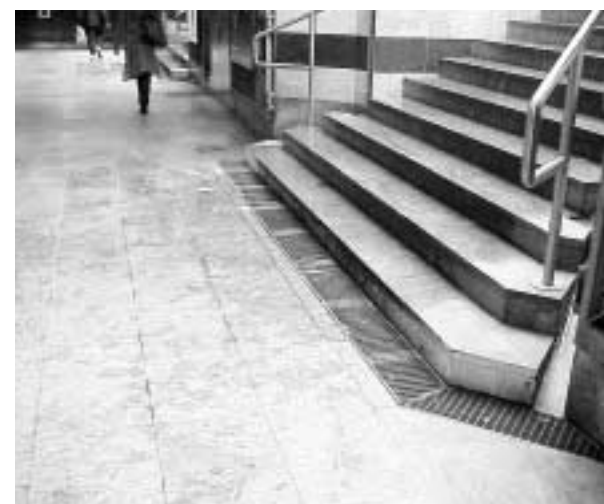
Bild 6: Treppenabgang in Passage: Das von den Treppen ablaufende Wasser wird mit Hilfe einer Entwässerungsrinne direkt abgeleitet, um Nässe am Bodenbelag zu reduzieren. Problematisch sind geschliffene Natursteinbeläge auf Flächen, auf die Schneematsch getragen wird. Bei Nässe und Schmutz ist die Gleitsicherheit ungenügend.
