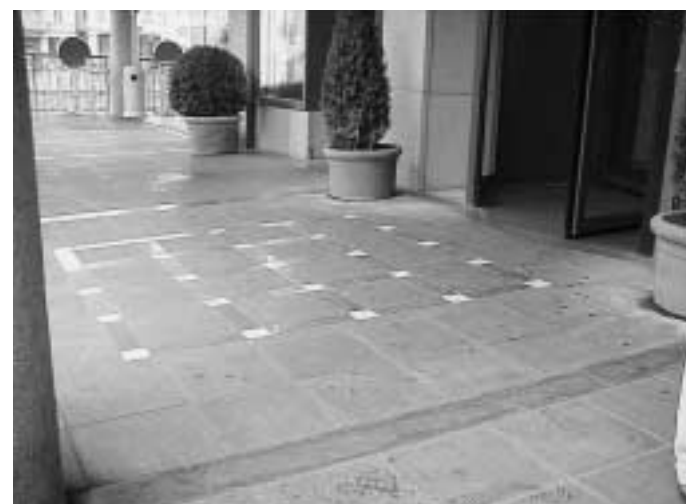
Bild 5: Ein Hoteleingang wird durch Einlagen sichtbar gemacht. Selbst schmale Einlagestreifen mit polierten Oberflächen reduzieren die Gleitsicherheit erheblich.
